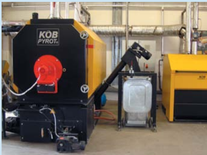
Современные теплоэнергетические установки
