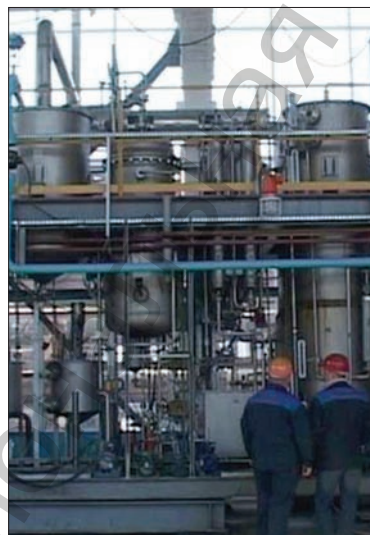
Рис. 3. Установка для производства метиловых эфиров жирных кислот в ОАО «Гродно Азот»
