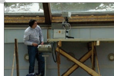
Рис. 1. Лазерная аппаратура на месте обследования корродировавших конструкций
