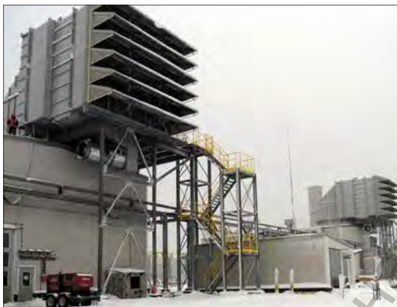
Рис. 7. Импульсное КВОУ с самоочищающимися фильтрами ASC компании AAF для газовой турбины Trent60 мощностью 50 МВт компании Rolls Royce (компрессорная станция «Портовая» магистрального газопровода «Северный Поток»)
